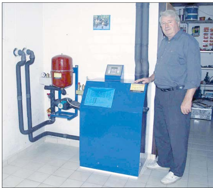
Sein ganzer Stolz ist die Wärmepumpe. Jan Harm Große Deters hat sich nach detaillierten Abwägungen für diese Art der Energiegewinnung entschieden. Das Stueurelement steht in seinem Keller. Bild: Osthaus
